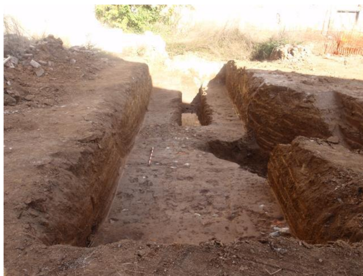
Vista general de la rasa 200 un cop finalitzada la seva excavació a la cota que apareix l'estrat 203.
